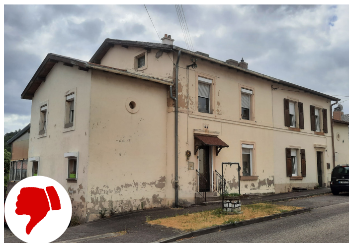
Maison de ville à annexe à oculus, ayant perdue ses volets battants bois. Elle a subi une dénaturation par le remplacement de ces derniers par des caissons de volets roulants sous linteaux
