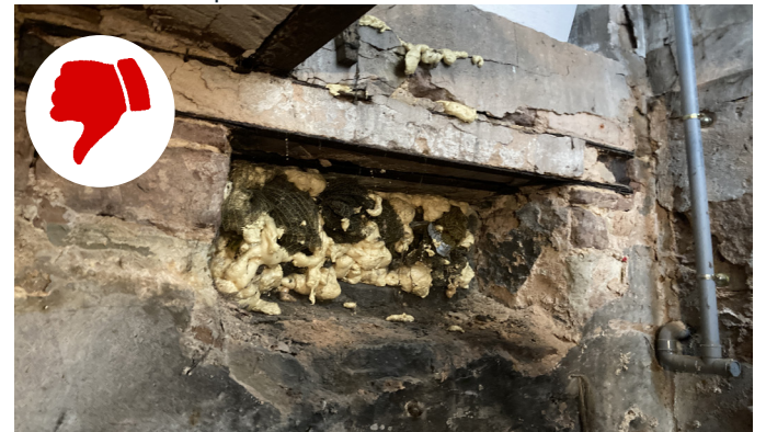
Soupirail de cave, d'une maison minière; calfeutré bloquant la ventilation de cave nécessaire - Source : Urbanis & Tholos architecture
