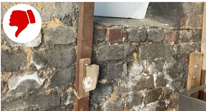
Soupirail de cave calfeutré et présence de remontées capillaires Source : Urbanis & Tholos architecture
