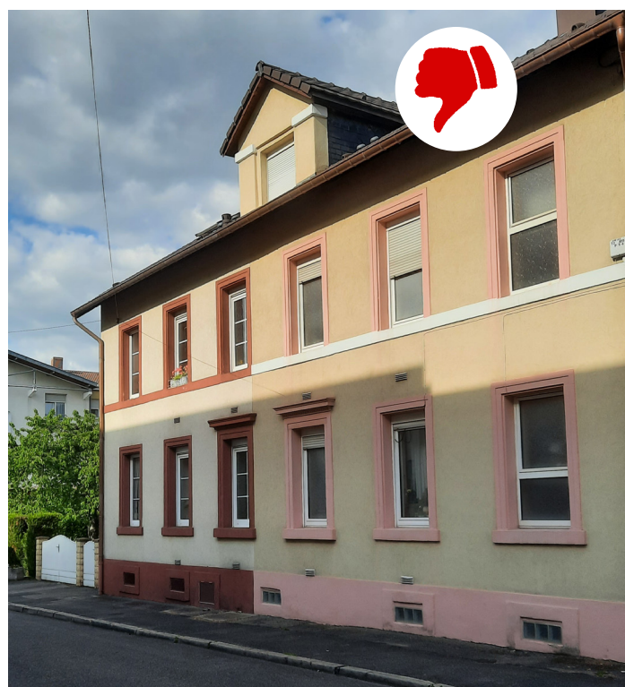
Ci-dessus, fenêtres modernes non adaptées à l'architecture du bâtiment.
