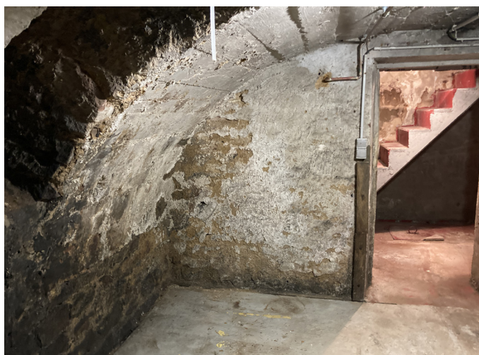
Voûte en pierre d'une maison minière avec perte de l'enduit à la chaux et du mortier structurel - Source : Urbanis & Tholos architecture
